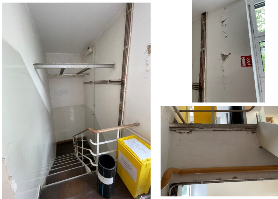
Slika 21. Pukotinsko oštećenje na vanjskom zidu i na podestu kod stubišta S3
