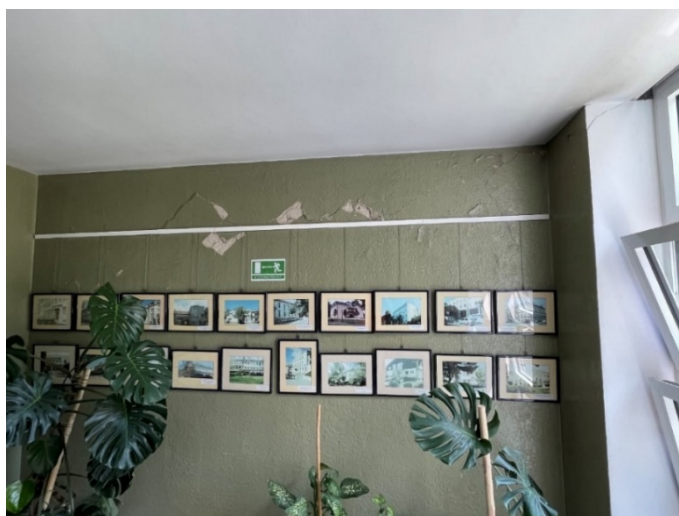
Slika 19. Pukotinsko oštećenje na međupodestu stubišta S1
