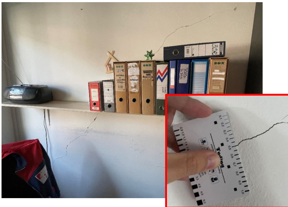
Slika 8. Karakteristična pukotinska oštećenja prizemlja
