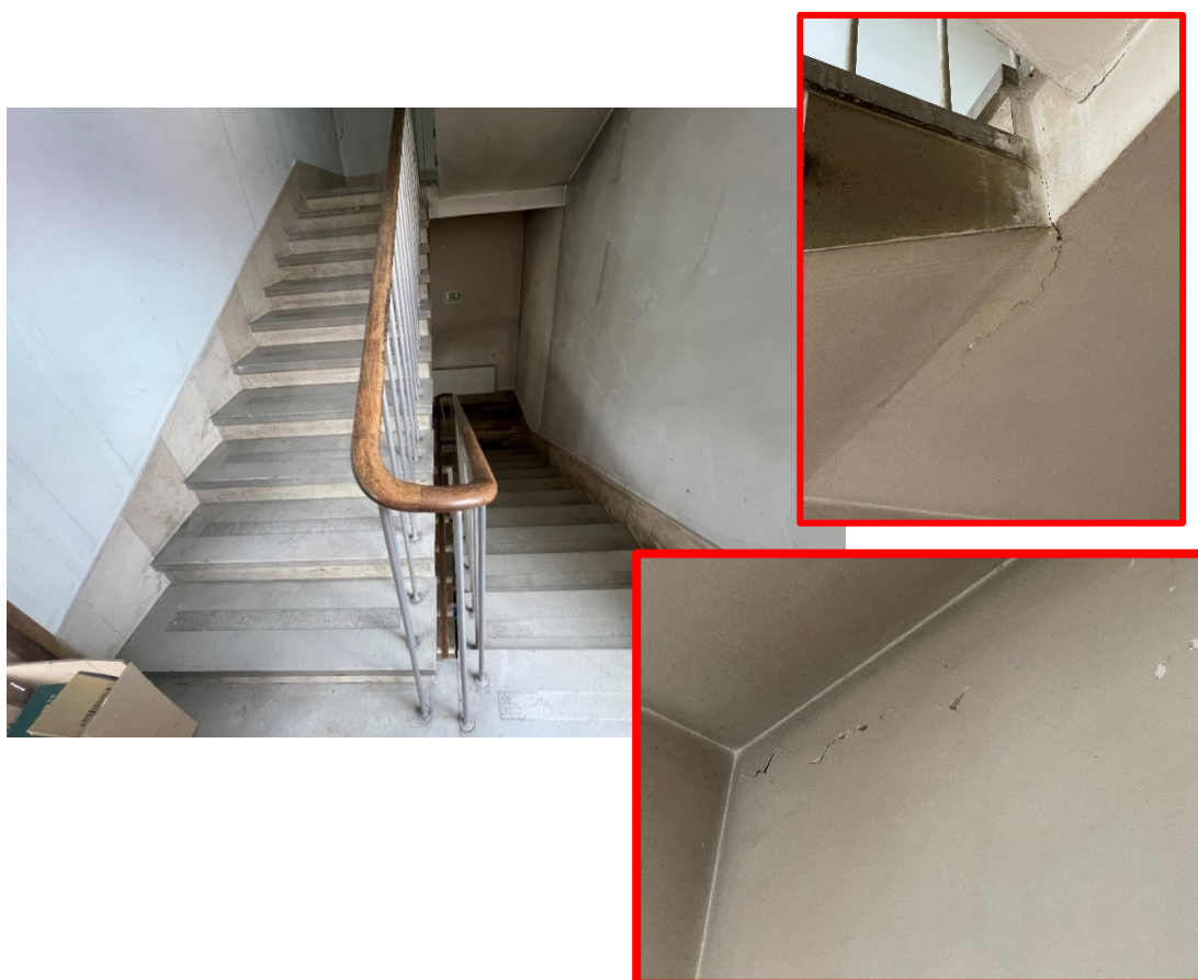
Slika 22. Pukotinsko oštećenje na zidovima međupodesta i na stubišnom kraku stubišta S2
