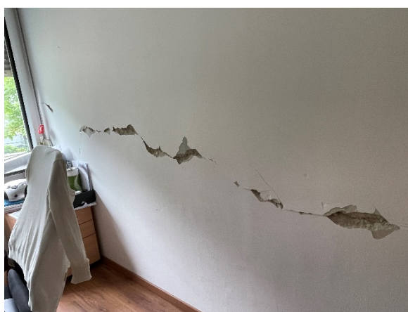
Slika 14. Horizontalna pukotina na zidu međupodesta
