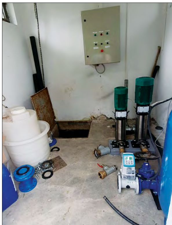
Slika 5. Nove pumpe i uređaj za dezinfekciju na području novog izvora Crni Lazi
